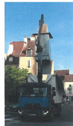
Vidage d'un conteneur enterré
